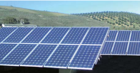
在南意大利建设的太阳能发电站
