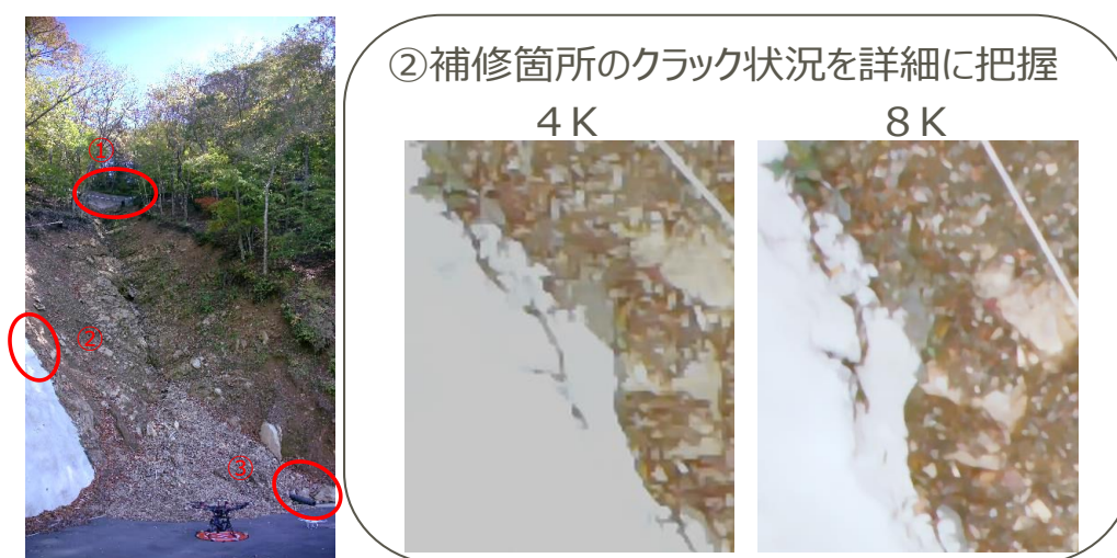
図 2.1-38 災害現場の解像度比較 (②補修箇所クラック)
