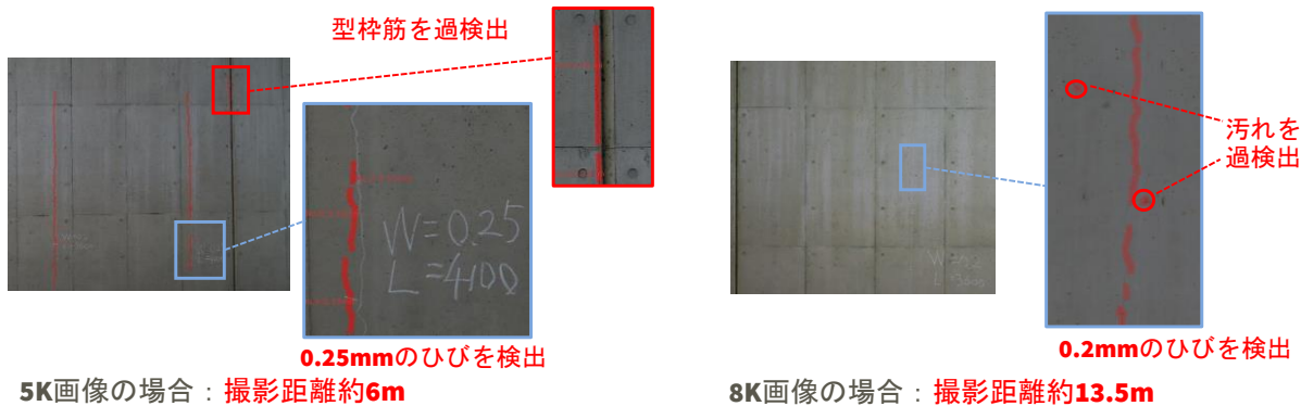
図 2.1-58 橋梁点検のひび自動検出
