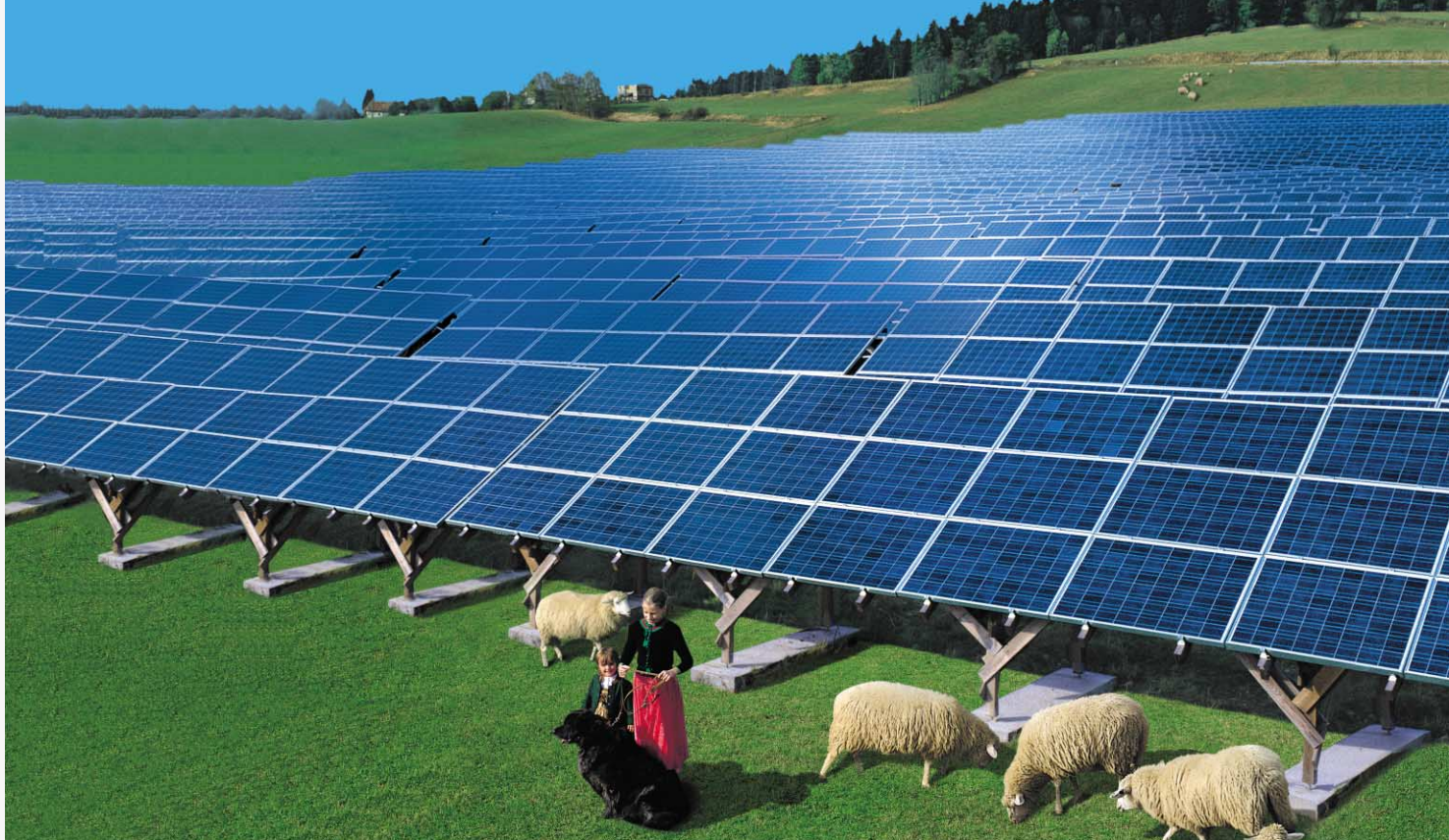
世界的規模で活躍するシャープ太陽光発電システム (1.7メガワットシステム/ドイツ・バイエルン州ゾネン)
