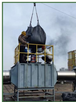
废气处理设施活性炭更换(每季度)
