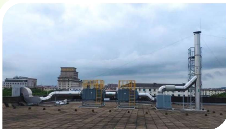
运行中的废气处理设施
