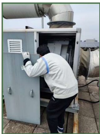
废气处理设施运行点检(每月)
