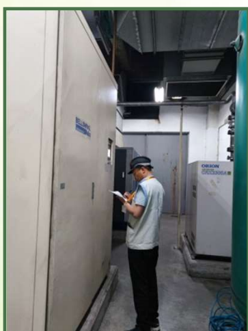
重要耗能设备运行点检(每日)
