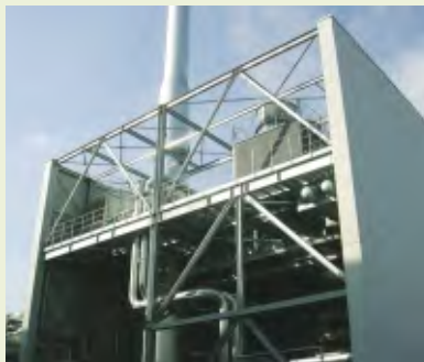
コ・ジェネレーション設備
