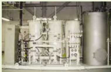
有機汚泥減量化システム
