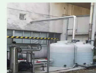
中水貯蔵タンク
