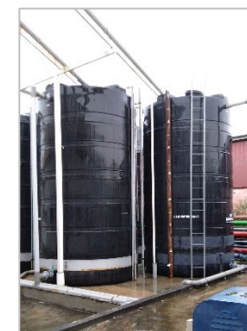
SMMの雨水タンク
