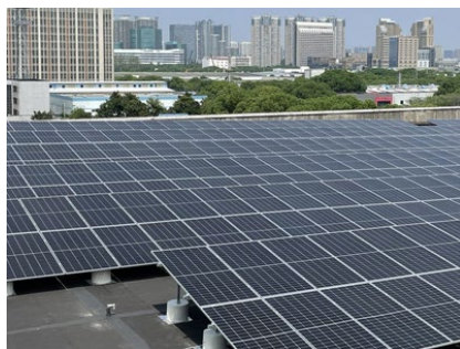
工場の屋根に設置された太陽光発電システム
