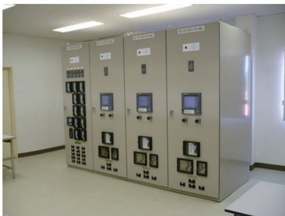
電力モニタ計測場所 (発電所内)
