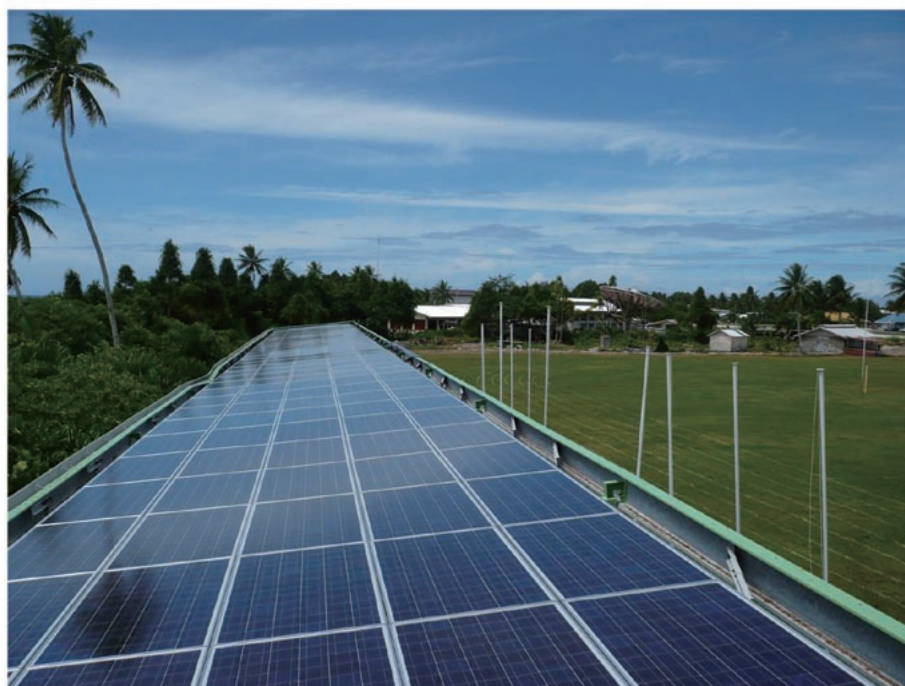
図9 太陽電池パネル全景 (サッカー場スタンド上30kW)
