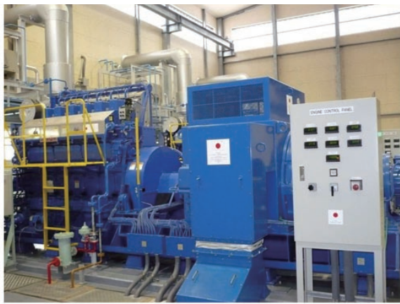
図3 ディーゼル発電機外観
