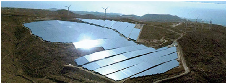
写真1 メガソーラ (スペインテネリフェ島)
