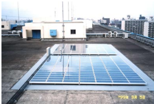
写真2 設置事例(フラットルーフ型)
