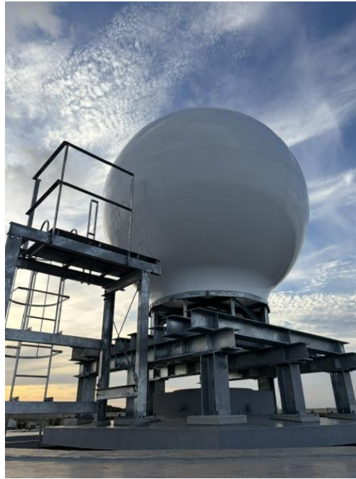
衛星通信設備（Ka帯パラボラ型ゲートウェイアンテナ）
