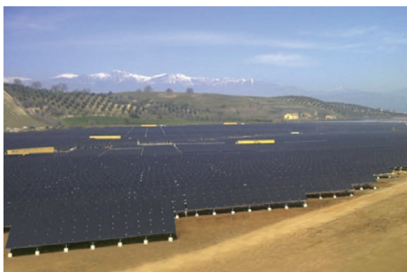
シャープおよびエネル・グリーン・パワー社による南イタリアの太陽光発電所(8.2MW) イタリア(カラブリア州アルトモンテ)
