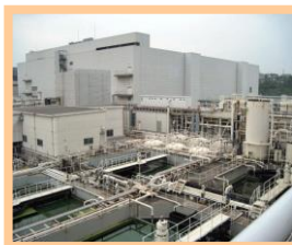
排水処理設備
