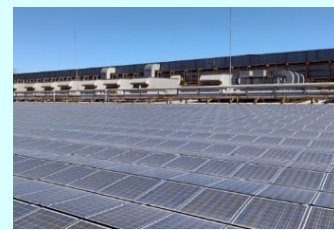
工場の屋上に設置している太陽光発電システム
