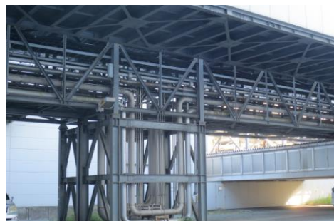
配管は高架橋に設置
