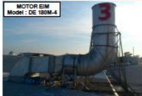
LEV EXHAUST FAN #3 SR013722
