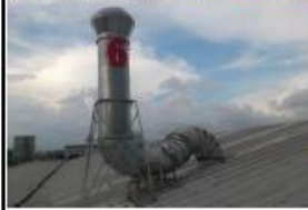
LEV EXHAUST FAN #6" SR007154
