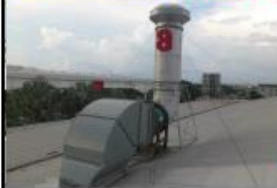
LEV EXHAUST FAN #8" SR007154
