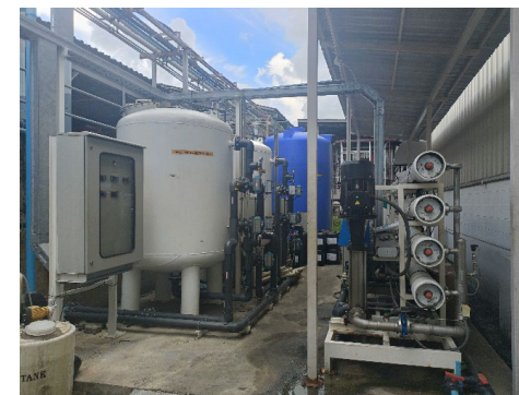
SATLの水リサイクル設備
